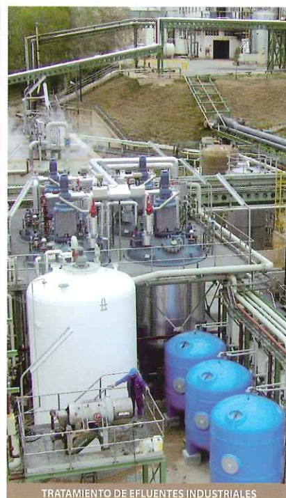
TRATAMIENTO DE EFLUENTES INDUSTRIALES
